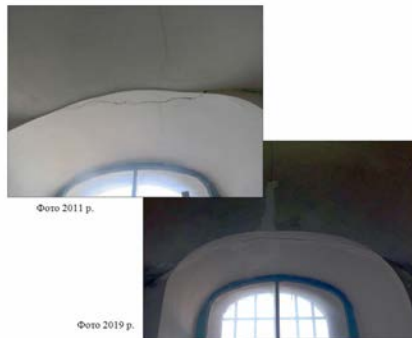
Рис. 2. Активізація розкриття тріщин внаслідок просідання ґрунтів в основі фундаментів корпусу № 4. Фото О. Вечерської
