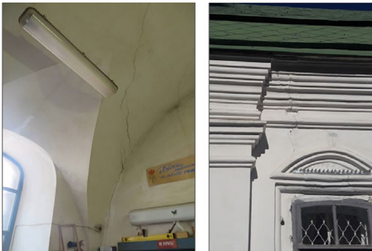
Рис. 3. Утворення тріщин в конструкціях корпусу № 4. Фото О. Вечерської
