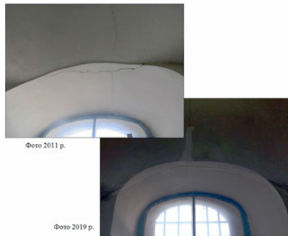
Рис. 2. Активізація розкриття тріщин внаслідок просідання ґрунтів в основі фундаментів корпусу № 4. Фото О. Вечерської
